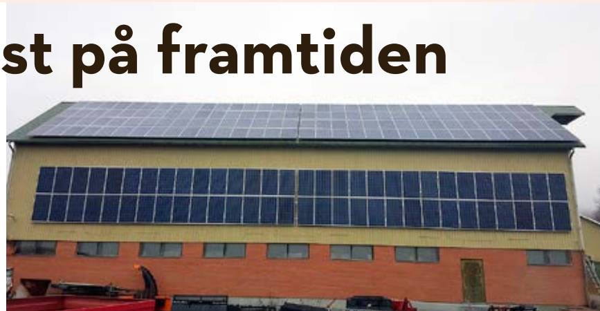
Hos Leif Nygren finns en av länets största privatägda solcellsanläggningar.
